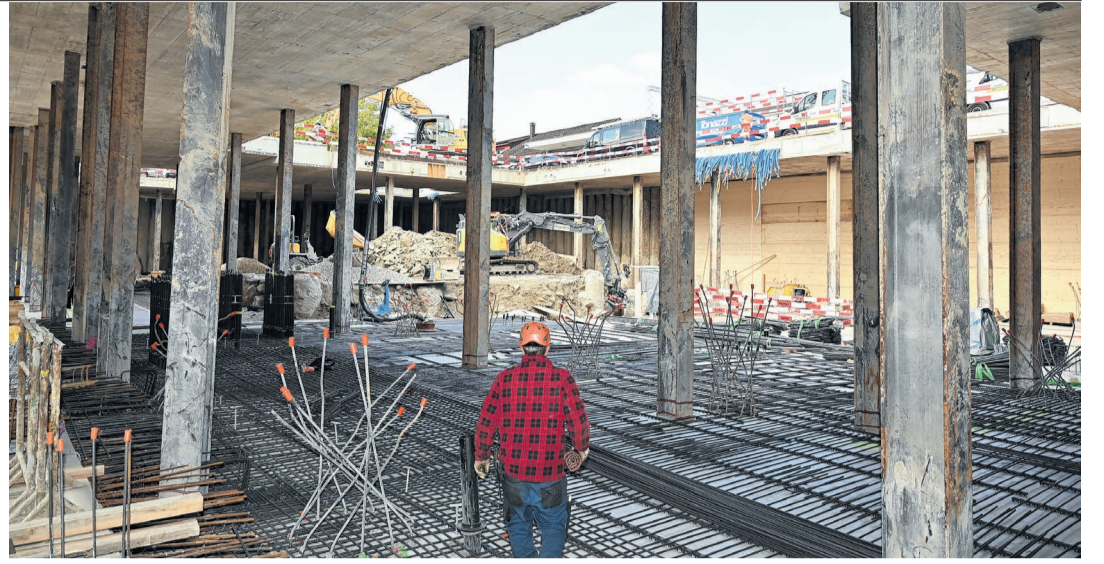
Im Untergrund tut sich eine eigene Welt auf, was die Passanten rund um den Bahnhof Pfäffikon kaum mitbekommen, weil zuerst die massive Betondecke erstellt und erst dann der Aushub begonnen wurde.
